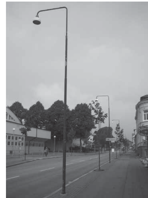
Ystadstolpen med armaturen Victor med påbyggnadshatt
