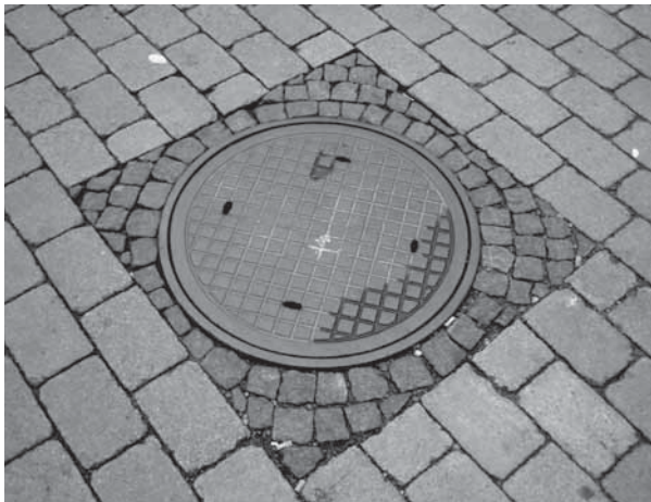
I plattytor ska all utfyllnad runt brunnar med mera beläggas med smågatsten eller nubbssten.
